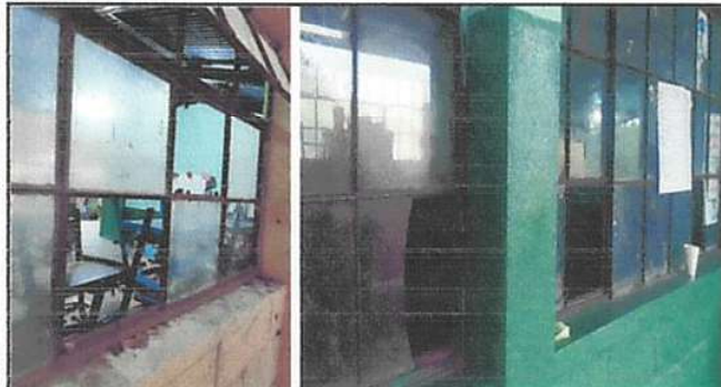
FOTO 3: LAS AULAS TIENEN VENTANAS DE METAL QUE ESTÁ PICADO Y CON LOS VIDRIOS QUEBRADOS CONSTITUYENDO UN PELIGRO PARA LOS ESTUDIANTES, ESPERANDO DESMONTAR Y CAMBIAR LA
